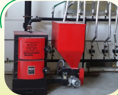
Geradores d'Água Quente
